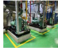
2023.4 고효율 냉동기 설치 [투자효과] 고효율 설비 도입으로 에너지 절감 / 온실가스 감축
